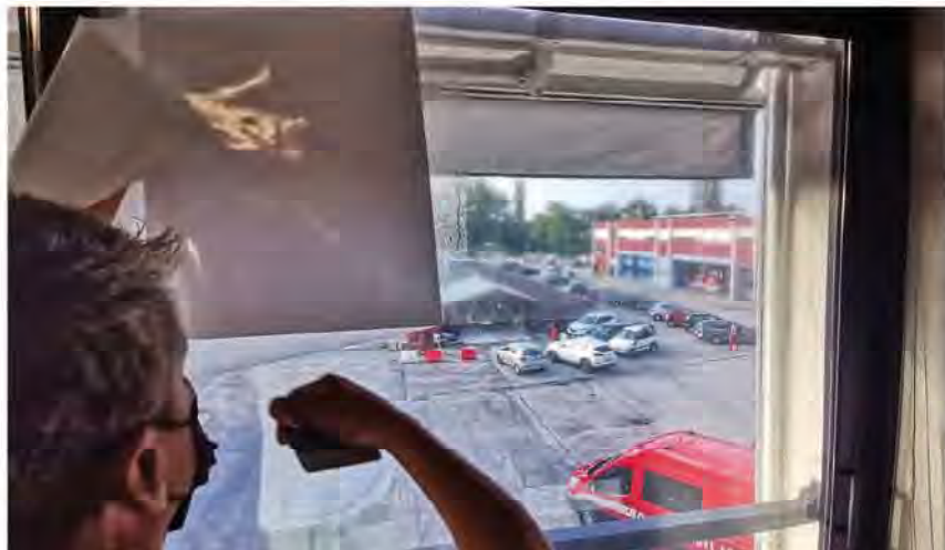
A VENEZIA UNA DELLE TANTE INSTALLAZIONI EFFETTUATE DA WIWELL
